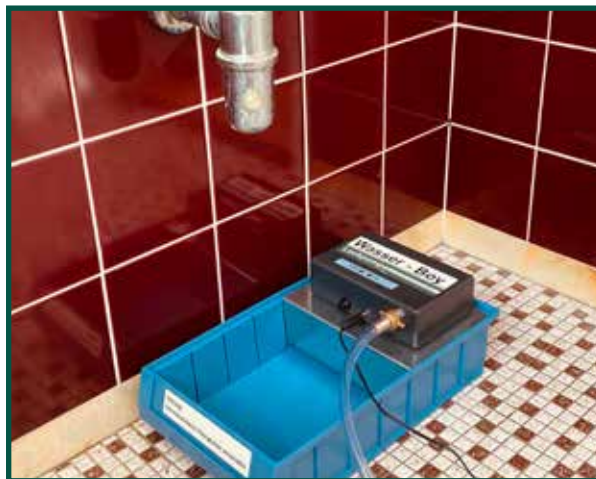
z.B. undichtiges Rohr
