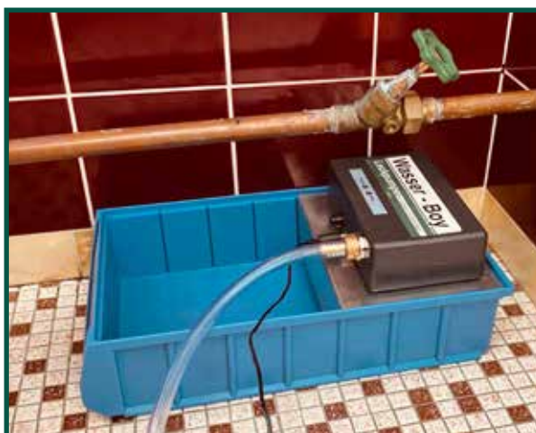
z.B. undichte Abflüsse
